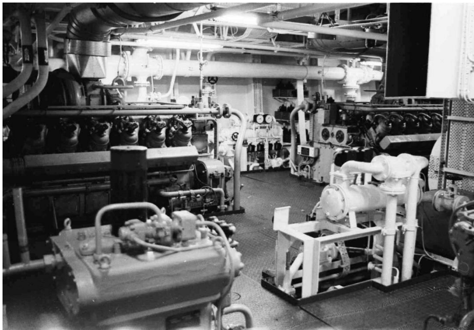
Foto från Antonia Johnsons maskinrum. Foto från H. Neréns samling.
